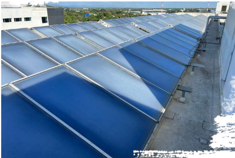
Placas del sistema térmico solar
