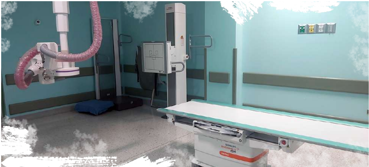
Sala de radiología con equipo automatizado
