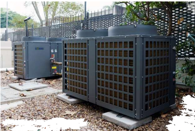
Paneles solares para agua caliente (arriba) y bomba de calor (abajo)
