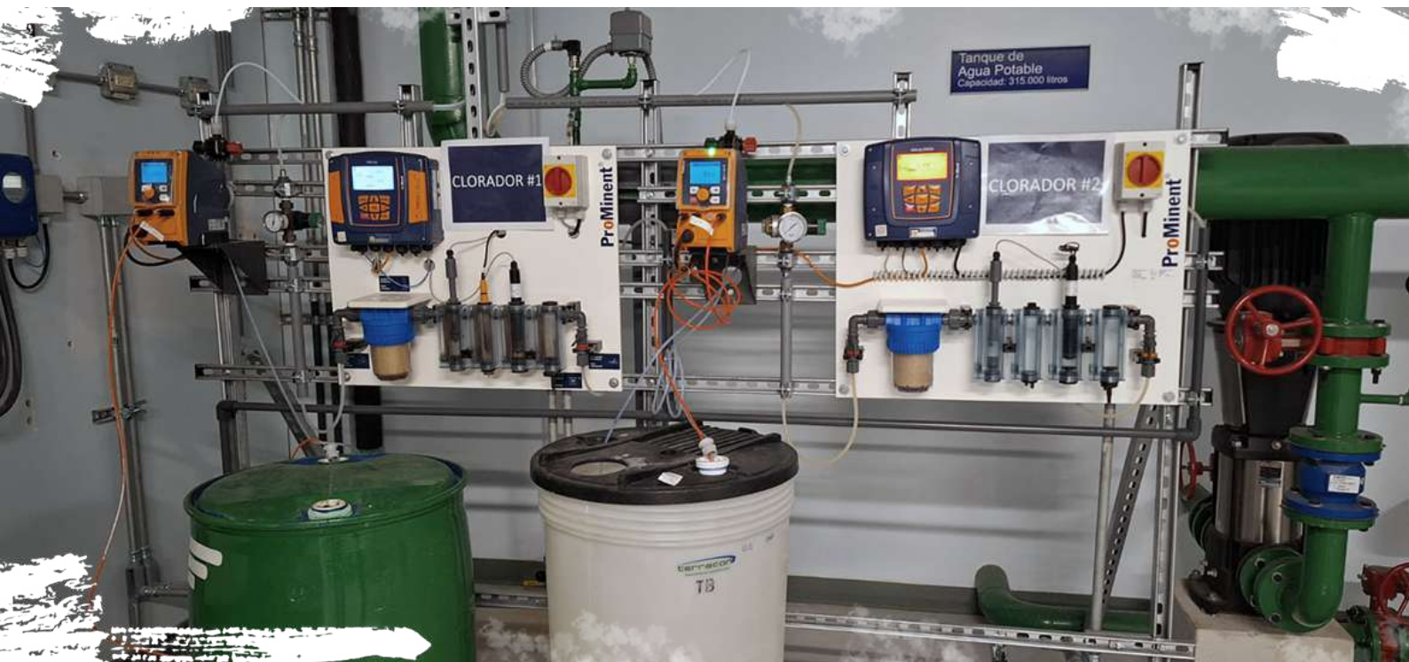
Sistema de cloración automatizado de agua del edificio Torre Este
